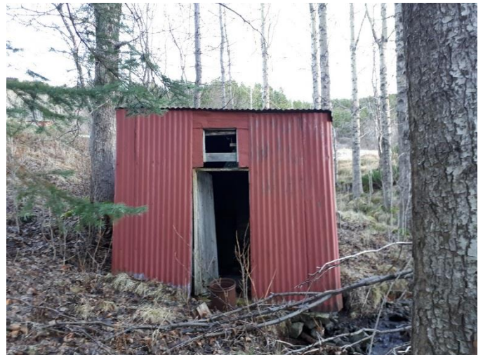
Mynd 6. Þvottahúsið í Hvammi, framan við það er annar af tveimur járnþottum þar sem vatn hefur verið hitað til þvotta. Ljóm:MHH.
